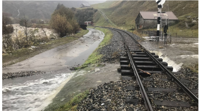
Unwetterschaden am Gleis in Realp
